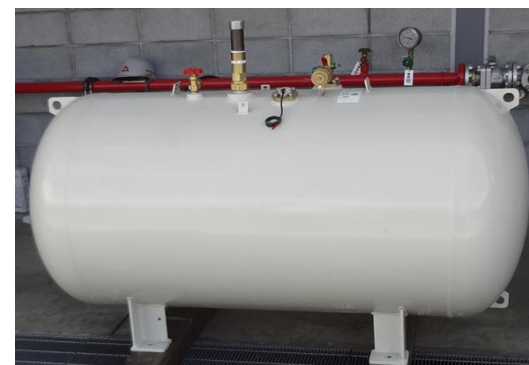
【20年目検査後再設置されたバルク貯槽】
