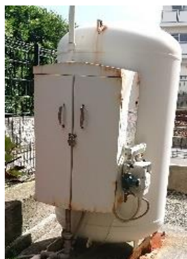
バルク貯槽全体
